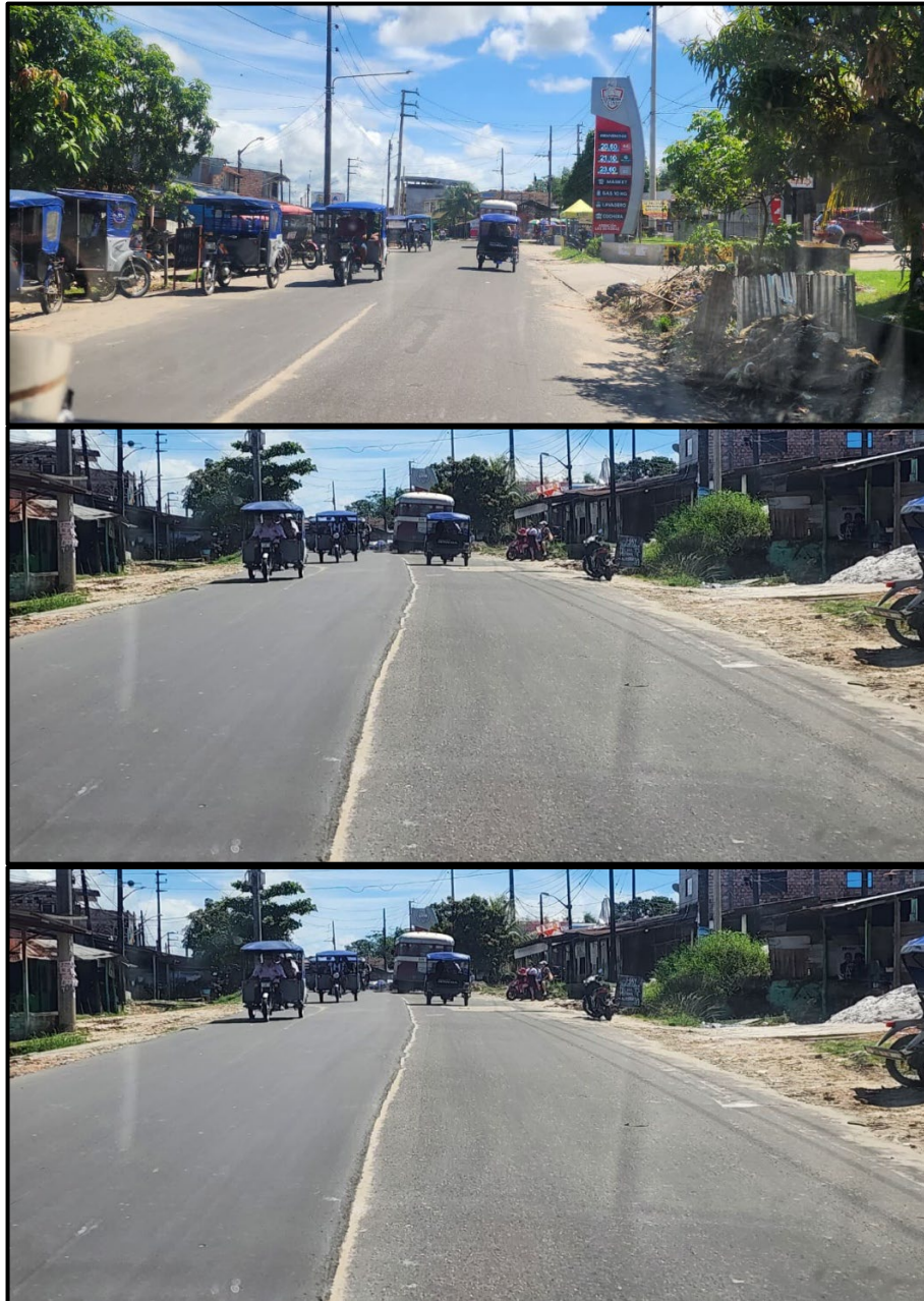
Figura N°25: Av. Participación, con reposición de carpeta asfáltica en lado izquierdo, sin señalización vertical ni horizontal
